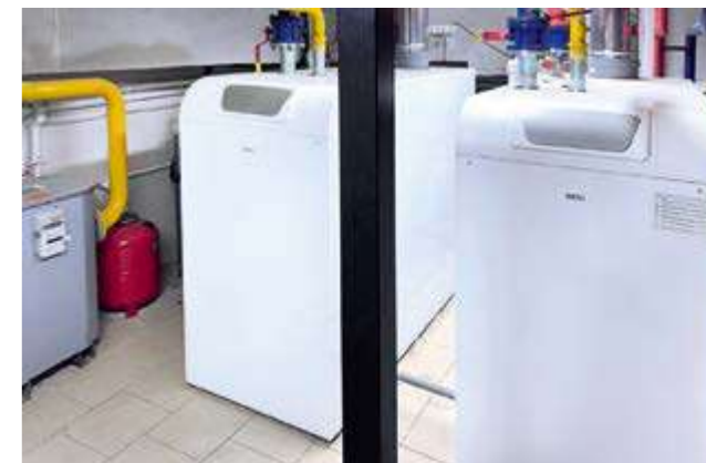
Ресторан Black Star Burger, г. Махачкала Общая мощность котельной - 860 кВт
