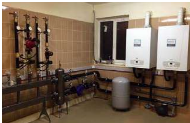
Автосервис, г. Москва Общая мощность котельной - 300 кВт
