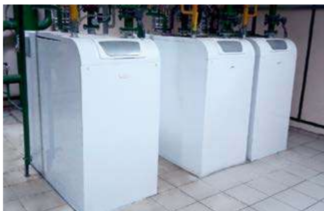
Офисный центр, г. Саратов Общая мощность котельной — 960 кВт
