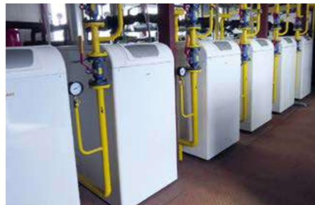
Жилой комплекс, г. Чебоксары Общая мощность котельной - 2,6 МВт
