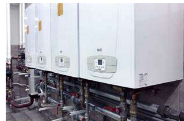
Общежитие, г. Усть-Луга Общая мощность котельной - 300 кВт
